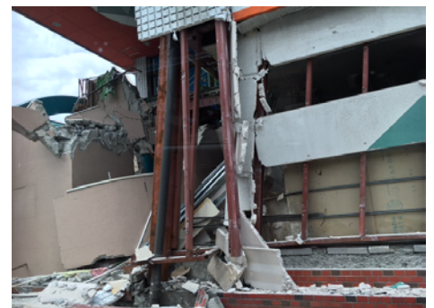
熊本市内の倒壊家屋（4/16 撮影）
