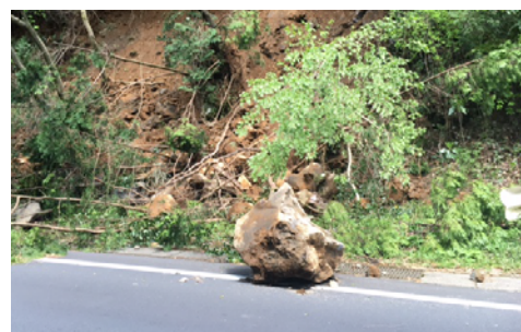
大きな岩が崩れ落ちていました。（4/17撮影）
