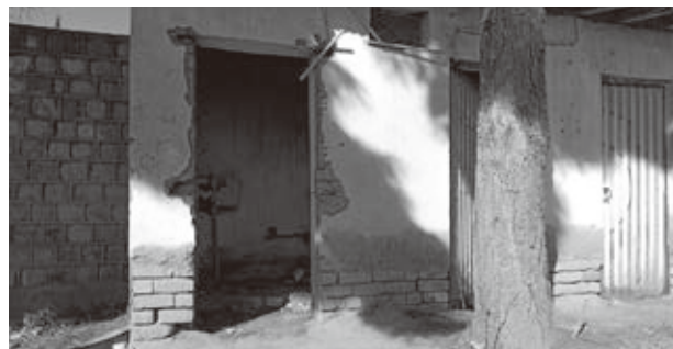
劣悪な状態にあるトイレ
