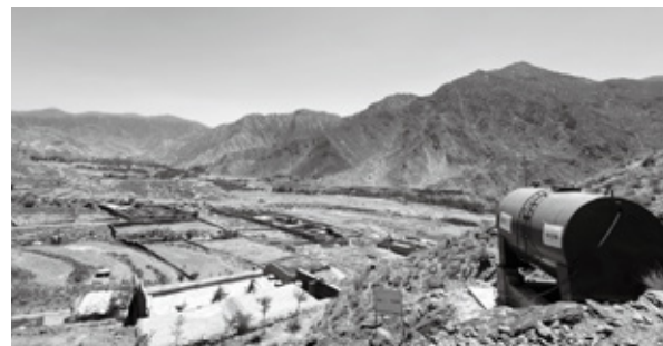
村を見下ろす山肌に、住民の方々と共に設置した貯水タンク。
